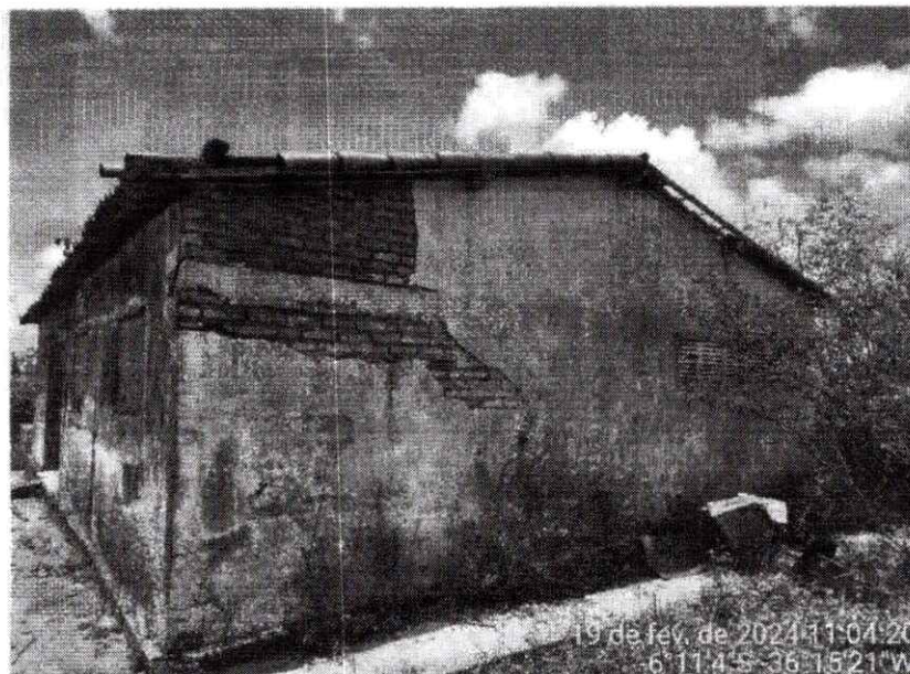
Figura 6: DESPLACAMENTO DE REBOCO
