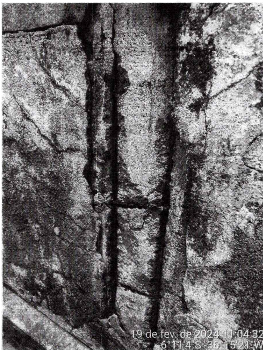
Figura 2: EXPOSIÇÃO DAS ARMADURAS DE AÇO
