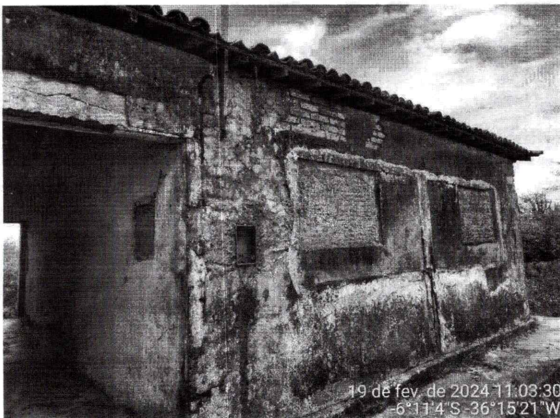
Figura 3: DETERIORAÇÃO DA ESTRUTURA
